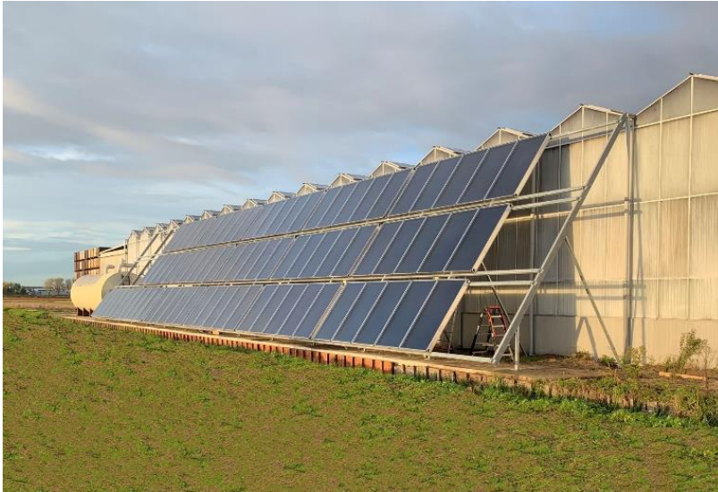
Abbildung 18: Anlehn-Solarfassade mit Flachkollektoren
