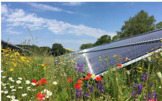
Abbildung 20: Solarthermische Anlage in Randegg (Quelle: Hamburg Institut (2019): 39)
